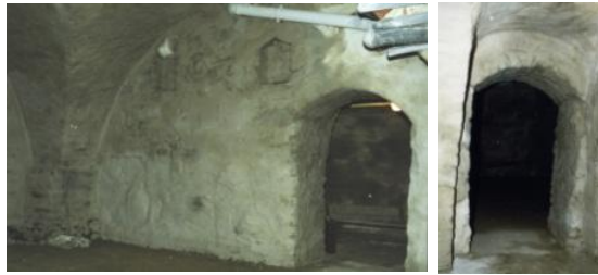
Ryc. 103-104. Zdjęcie piwnic kamienicy przy ul. Klasztornej 6. Stan w 1998 r. Ściana północna z wnękami oświetlonymi, przypuszczalnie kaplicy p.w. św. Michała Archaniola. Fot. M. Szajerka. Ze zbiorów Muzeum im. ks. dr. Władysława Łęgi w Grudziądzu.
