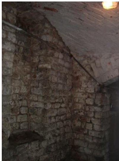
Ryc. 38. Murowa 28. Fragment muru obronnego. Stan z ok. 2007 r. Obecnie oryginalny nur jest częściowo zniszczony. Pomalowany został farbą emulsyjną – akrylową. Fugi wypełniono zaprawą cementową. Oryginalne spoino to glina. Fot. M. Szajerka.
